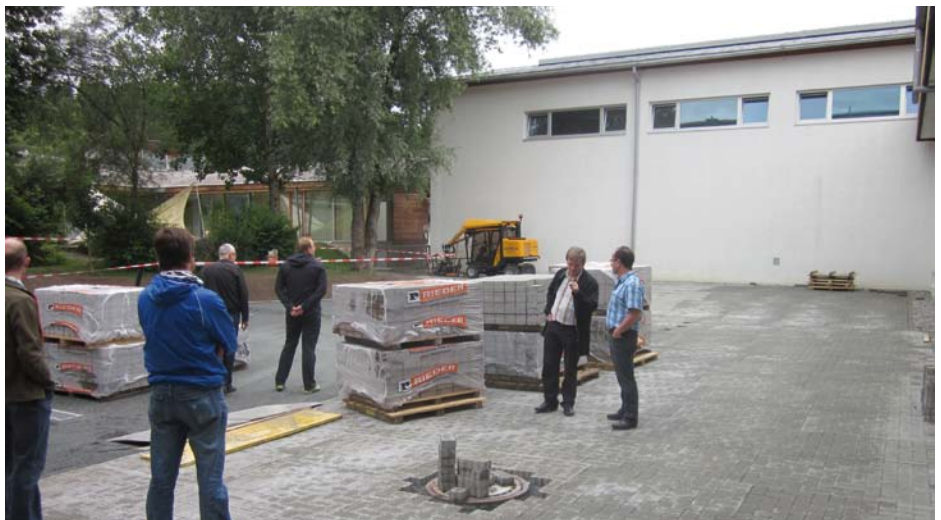
Die Bauarbeiten schritten zügig voran - so kann der Schulhof nun ideal für Schüler und außerschulische Veranstaltungen genutzt werden.
